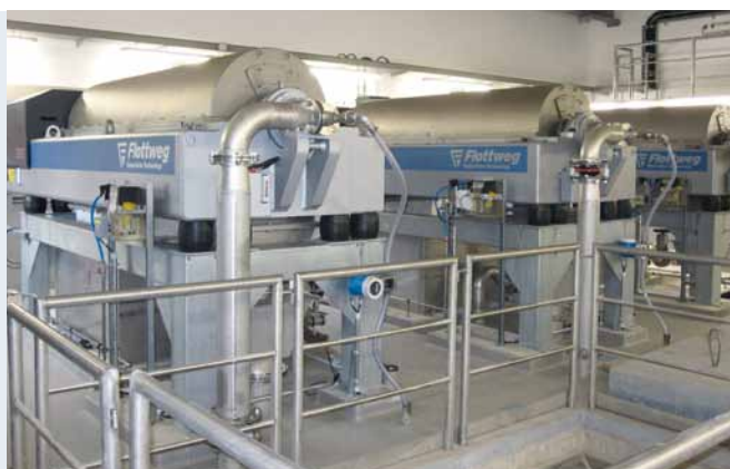
DECANTER Z5E en una depuradora alemana
