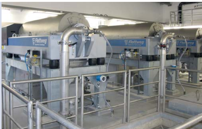
Wirówki Z5E Decanter w jednej z niemieckich oczyszczalni ścieków
