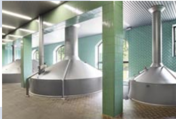
Der im Sudhaus anfallende Heißstrub wird über den FLOTTWEG DECANTER getrennt
