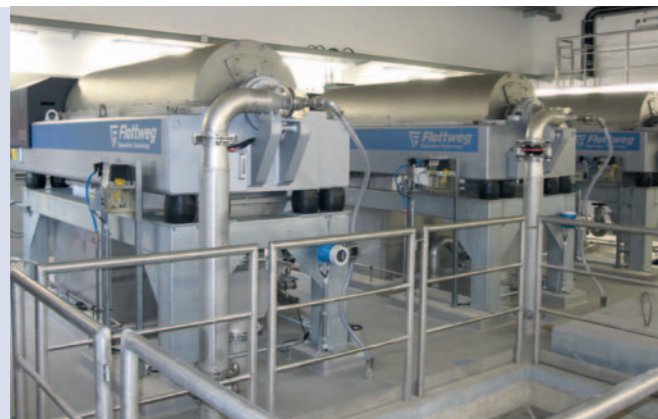
DECANTEUR Z5E dans une station d'épuration allemande
