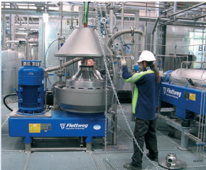
Séparateurs FLOTTWEG sur site
